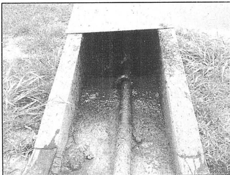
Figura 7 - Caixa de descarregamento de resíduos
